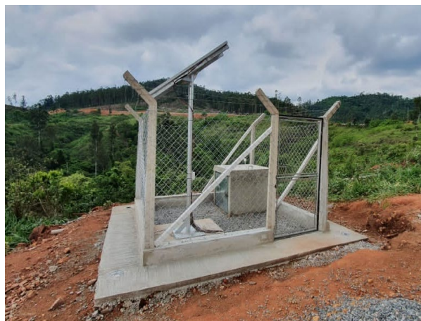
Foto 22: Instalação do Sismógrafo para monitoramento de sismos (Programa de Monitoramento Sismológico) (07/12/2020))
